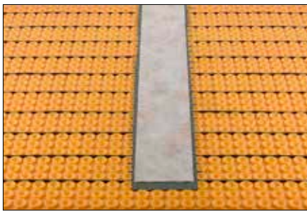
Stoßabdichtung mit Schlüter®-KERDI-KEBA
